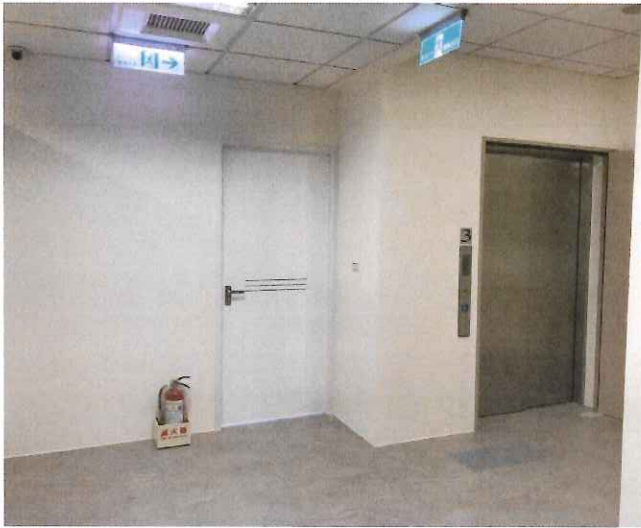
【消防及安全設備】
